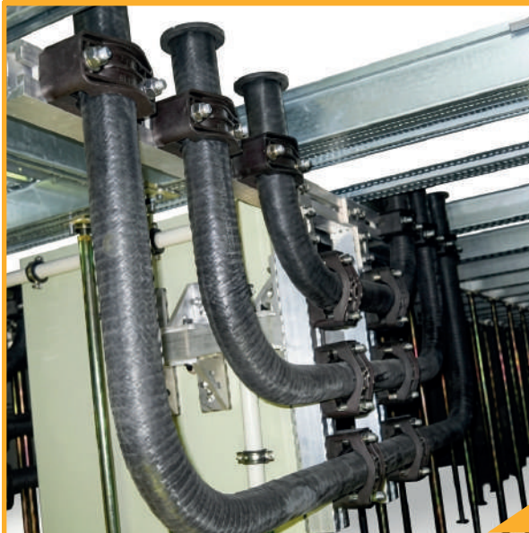
Conexión de aparamenta con aislamiento de aire
