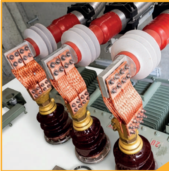
Conexión SIS al transformador mediante conectores de cobre de alta flexibilidad
