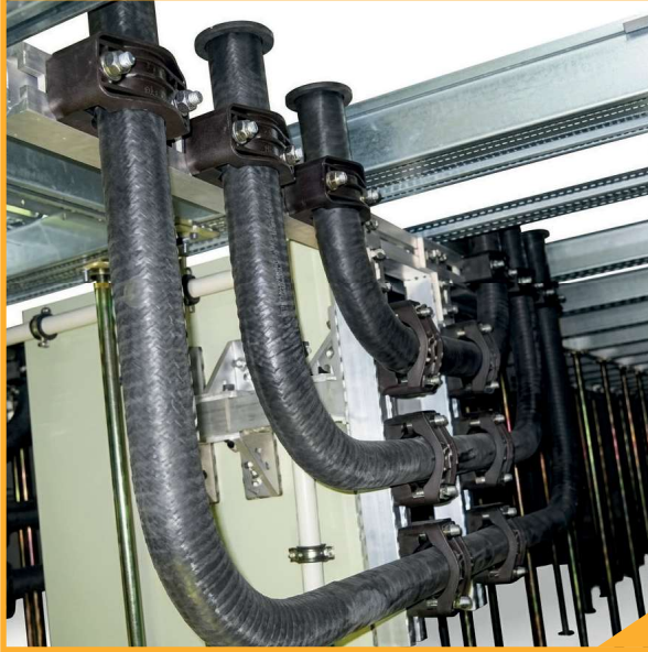
Conexión de aparamenta con aislamiento de aire
